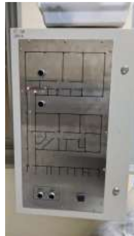
Foto 12: Equipamento para controle de acesso ao modulo
