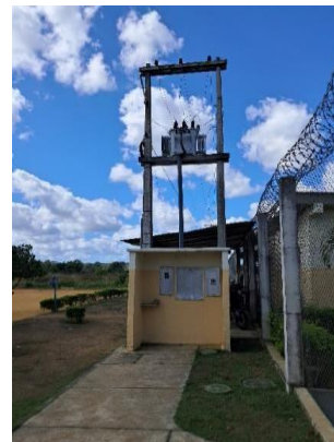
Foto 10: PADRÃO DE ENTRADA DE ENERGIA ELÉTRICA.
