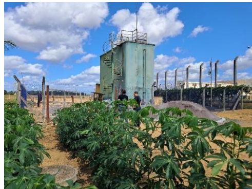
Foto 8: ESTAÇÃO DE TRATAMENTO DE ESGOTO.
