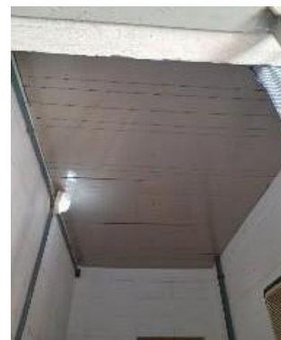
Foto 25: Imóvel vistoriado - FORRO DA S. DE CONTROLE.
