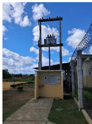
Foto 10: PADRÃO DE ENTRADA DE ENERGIA ELÉTRICA.
