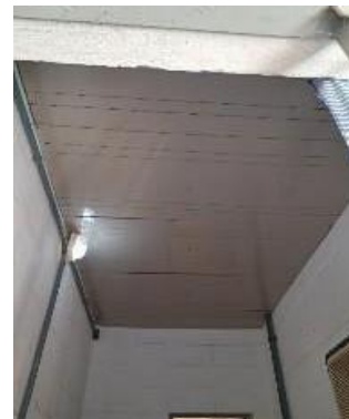
Foto 25: Imóvel vistoriado - FORRO DA S. DE CONTROLE.
