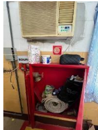
Foto 23: Imóvel vistoriado - SISTEMA DE INCÊNDIO COM
