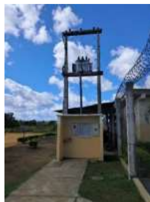
Foto 10: PADRÃO DE ENTRADA DE ENERGIA ELÉTRICA.
