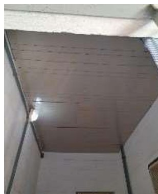
Foto 25: Imóvel vistoriado - FORRO DA S. DE CONTROLE.
