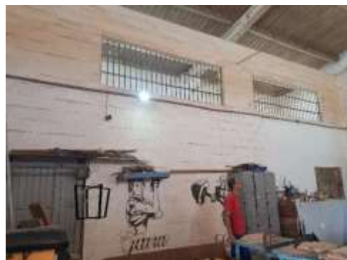
Foto 37: Imóvel vistoriado - VENTILAÇÃO - OFICINA 1.
