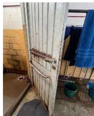
Foto 31: Imóvel vistoriado - Porta do banheiro - OFICINA 2.
