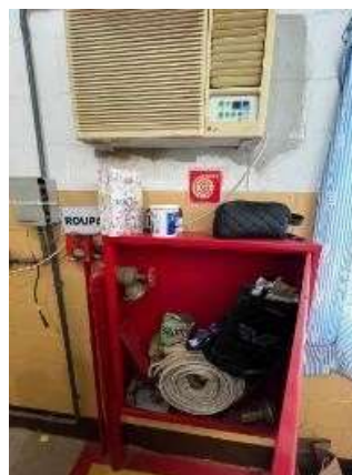
Foto 23: Imóvel vistoriado - SISTEMA DE INCÊNDIO COM
