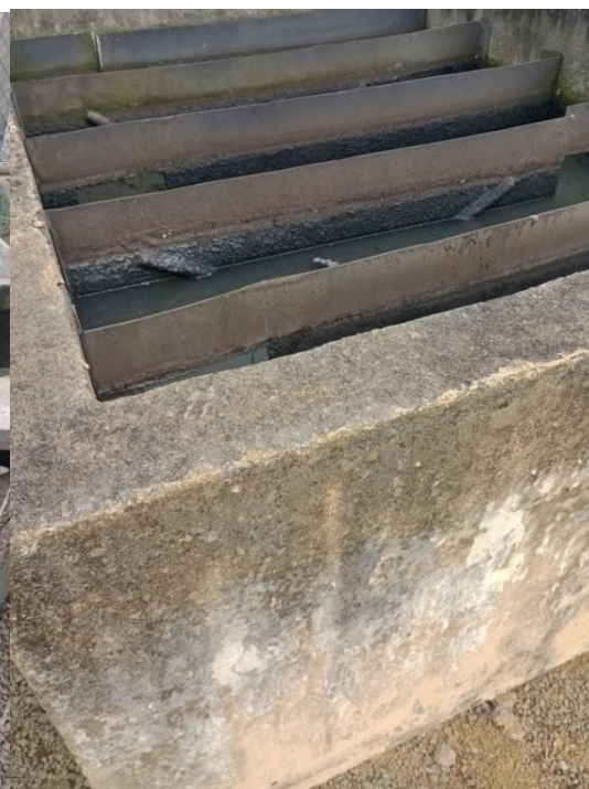
Figura 9: Tanque de Desinfecção
