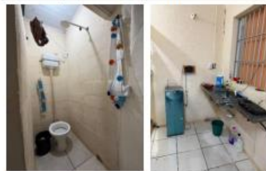
Figura 6 e 7 - Instalações Hidráulicas e Sanitárias da "ÁREA EM L"
