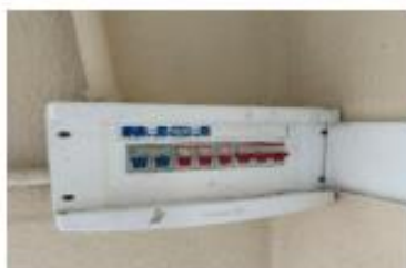
Figura 8 - Quadro elétrico existente da "ÁREA EM L"
