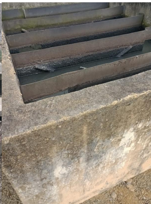
Figura 9: Tanque de Desinfecção
