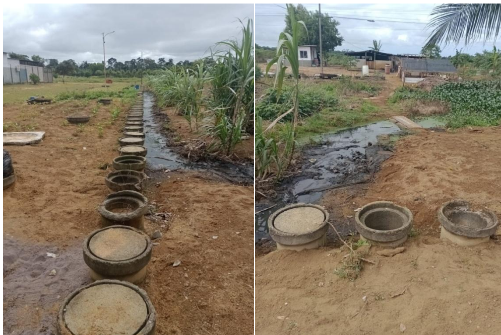
Figura 10 e 11: Vazamento de esgoto no entorno da vala de infiltração
